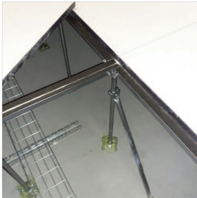
Struttura KGX4 con tirante antisismico
